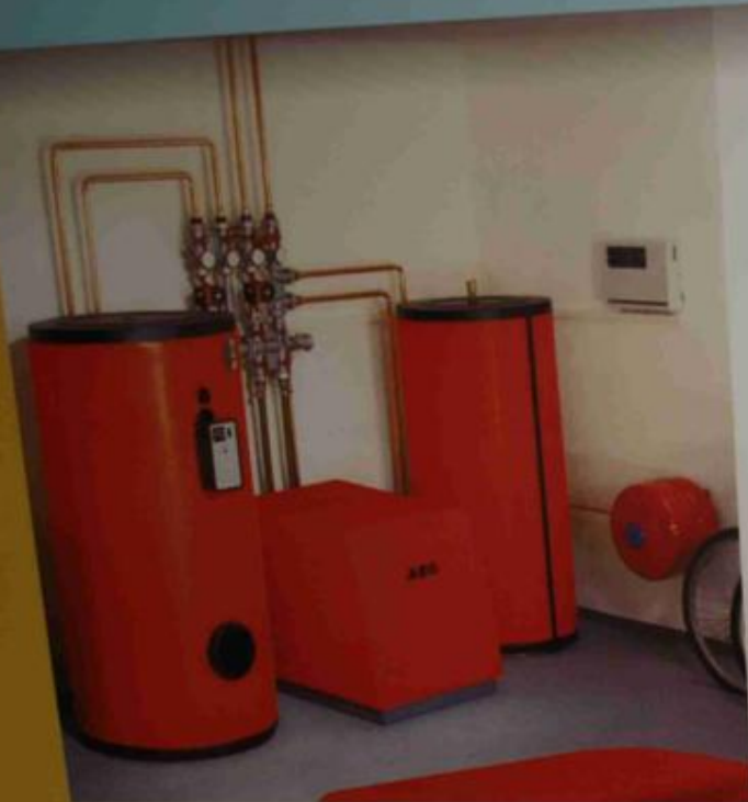
Tepelné čerpadlo AEG s topným výkonem 18 kW s výměníkem tepla a zásobníkem horké vody.
